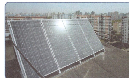
Рис. 34. Солнечная батарея на крыше жилого дома
